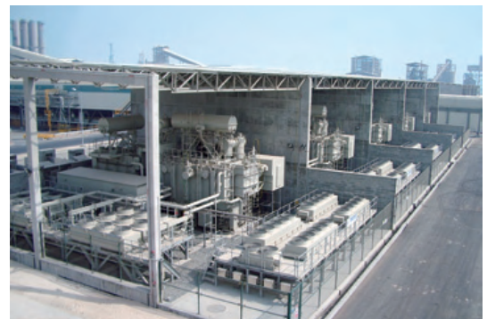
EMAL社のアルミ製錬工場。写真は第一期のSフォーマ(12台納入済)。現在施工中の第二期工事(6台納入予定)が完成すれば、世界最大級のアルミ製錬所となる
