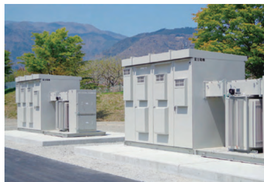
パワーコンディショナ (1MW×2台)
