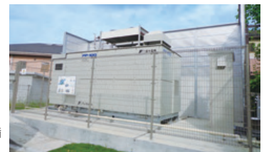
住宅地に隣接して設備された燃料電池
