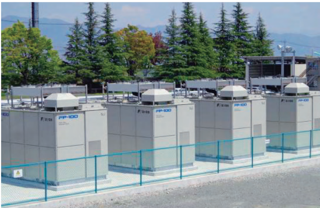
スマート工場(山梨事業所)に設置された燃料電池
