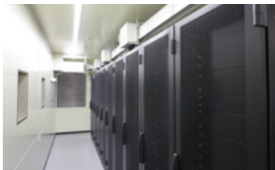
データセンター
