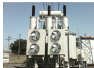
電力用変圧器
