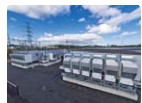
雪水冷房を適用したデータセンター
