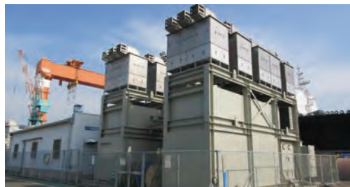
陸上電力供給システム（外観）
