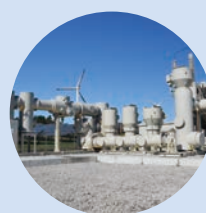
変電システム
