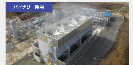
バイナリー発電 出光大分地熱株式会社様 瀬上バイナリー発電所 (5.05MW 大分県)
