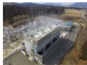
滝上バイナリー発電所
