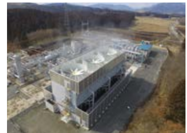
滝上バイナリー発電所
