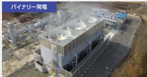
出光大分地熱株式会社様 滝上バイナリー発電所(5.05MW 大分県)
