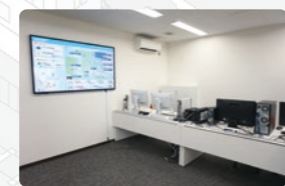
そうまIHIグリーンエネルギーセンター管理棟内(エネルギーマネジメントシステム)
