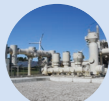
変電システム
