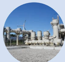
変電システム
