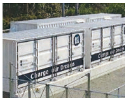
蓄電システム
