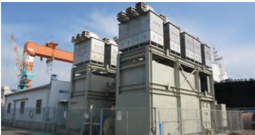
陸上電力供給システム (外観)
