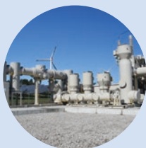
変電システム
