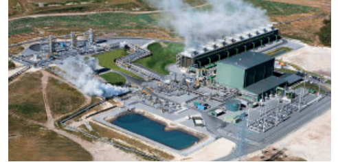
ニュージーランド ナ・アワ・プリア地熱発電所
