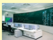
電力監視制御装置
