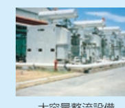
大容量整流設備
