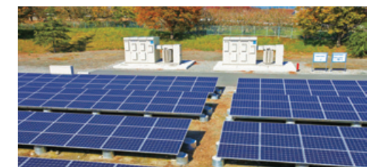
再生可能エネルギーの固定価格買取制度を背景にメガソーラーの建設が増加し、太陽光発電システムの受注が伸びました。
