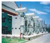
大容量整流設備
