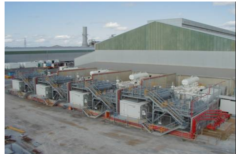
オーストラリア 某アルミ精錬所向け 大容量整流設備
