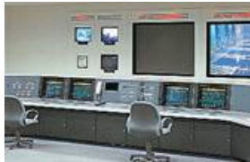
プラント制御システム
