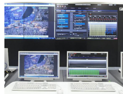
地域エネルギー管理システム
