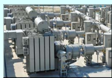
産業変電 (受変電設備)
