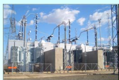
電力変電 (大容量変圧器)
