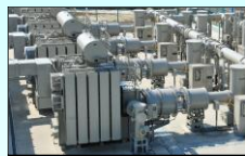
産業変電 (受変電設備)
