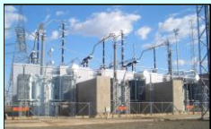
電力変電 (大容量変圧器)
