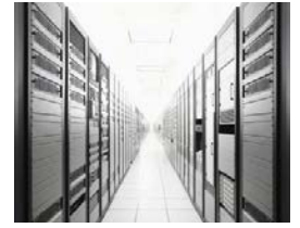
データセンター
