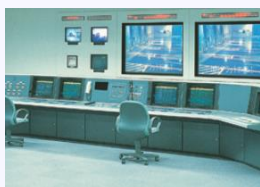
プラント監視制御 システム
