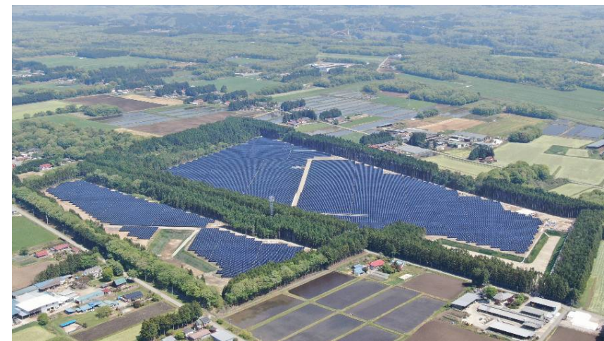
ファースト・ソーラー・ジャパン合同会社様 (画像提供元) 青木太陽光発電所 (建設工事中)
