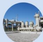
変電システム
