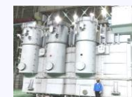
(大容量変圧器) 電力変電
