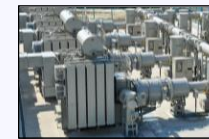
(受変電設備) 産業変電
