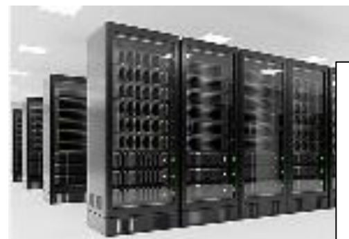
データセンター
