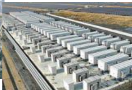
蓄電制御システム
