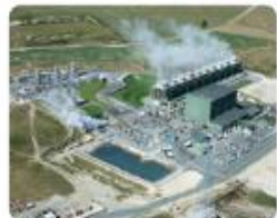
地熱発電設備
