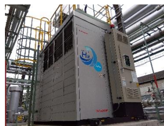
名古屋工場 水素ボイラー
