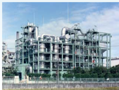
下水汚泥焼却プラント
