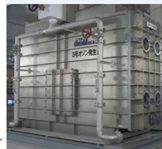
オゾン発生装置
