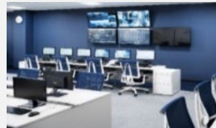
監視システム
