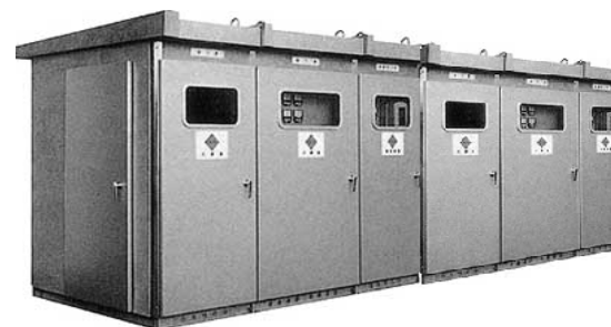
蓄電システム
