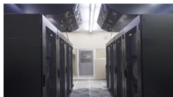
データセンター
