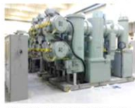
ガス絶縁開閉装置 (GIS)
