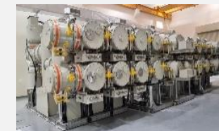
開閉装置 (移管)
