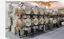
開閉装置 (移管)
