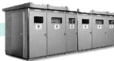
蓄電システム
