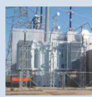
大容量変圧器
