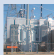
大容量変圧器
