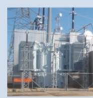
大容量変圧器
