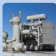
変電システム
