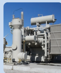
変電システム
