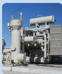
変電システム
