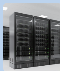
施設・電源 システム
