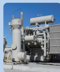
変電システム
