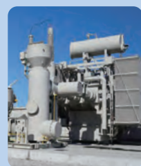
変電システム
