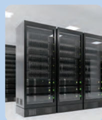
施設・電源 システム
