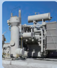
変電システム
