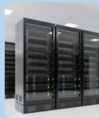
施設・電源 システム
