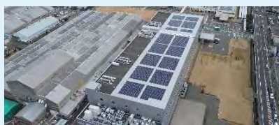
鈴鹿工場の太陽光発電設備
