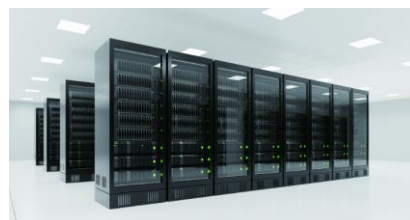
データセンター
