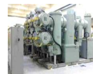
ガス絶縁開閉装置 (GIS)
