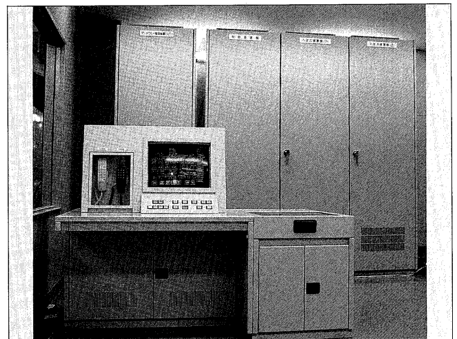
図6 月寒変電所の RS システム
