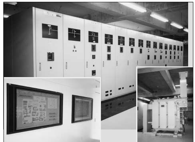
図 13 特高受変電設備および中央監視設備
