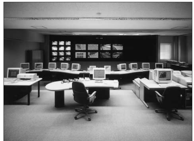
図 15 北陸支社施設制御室
